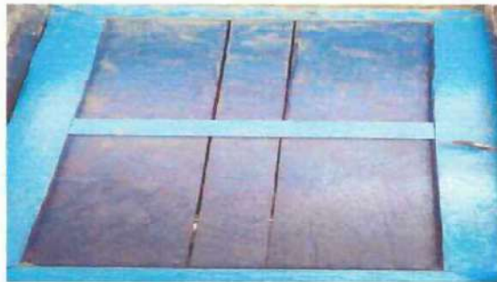
Foto 3: Se identifica el mal estado de la puerta debido al desgaste natural de la madera.
