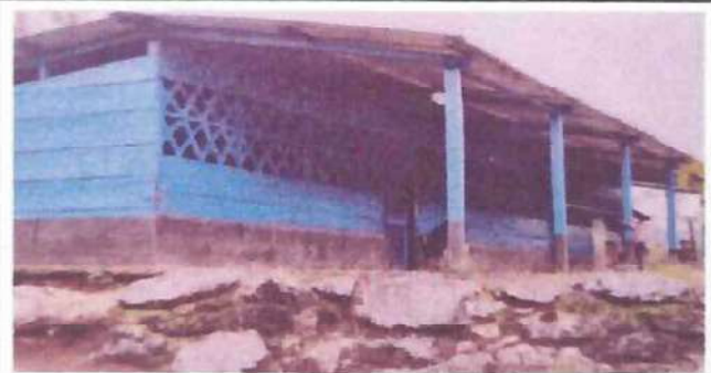
Foto 2: Se observa que la fachada del establecimiento muestra signos evidentes de deterioro, lo que indica la necesidad de remozamiento.
